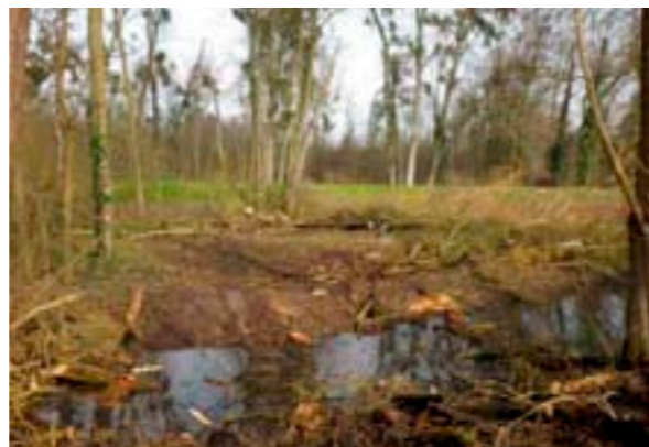
Mare "Joie de créer" : abattage d'une zone pour création d'une plage en pente douce
