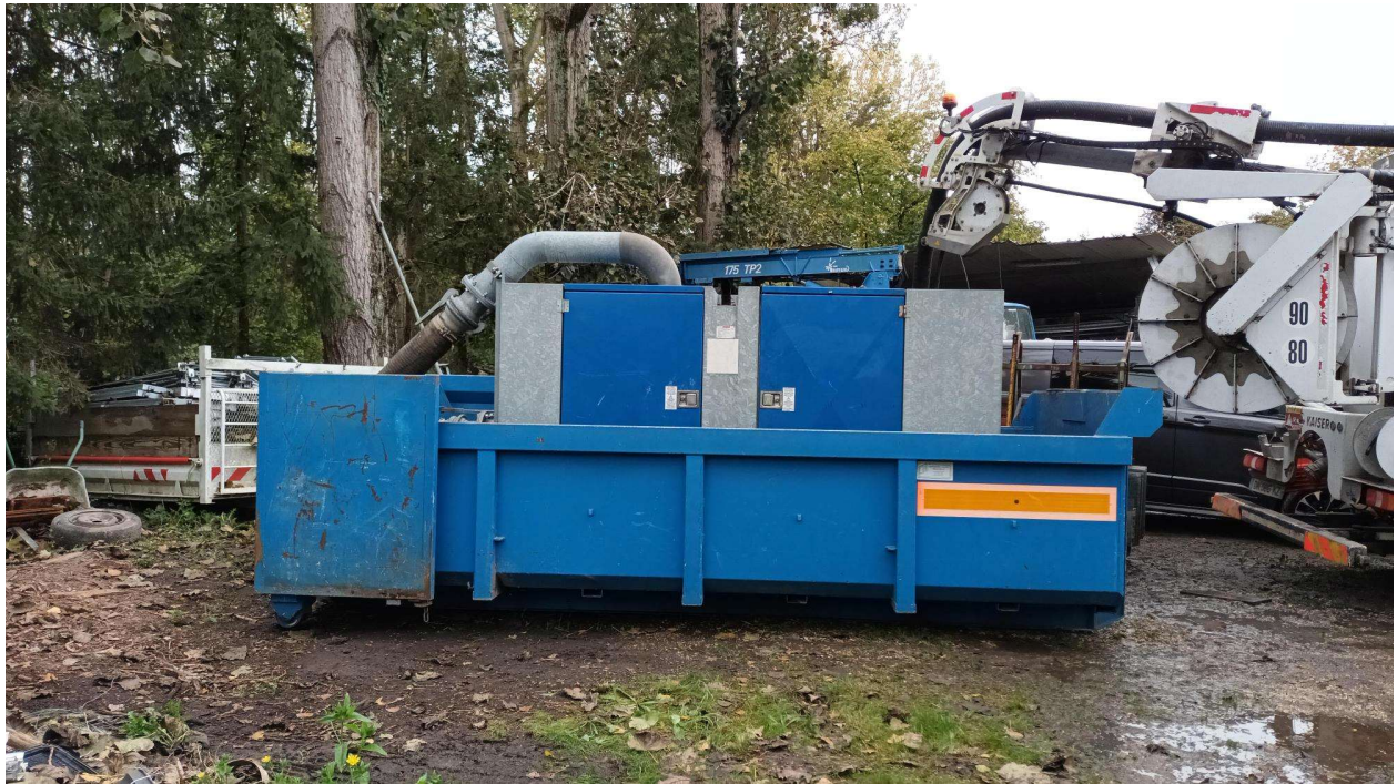
Groupe de pompage
