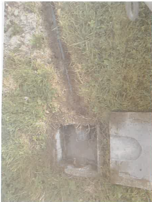
Rétention d'eau dans le regard
